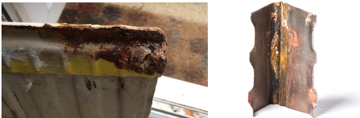
CORROSION PERFORANTE SUR RADIATEURS EN ACIER VUE EXTÉRIEURE (À GAUCHE) ET VUE INTÉRIEURE (À DROITE)
